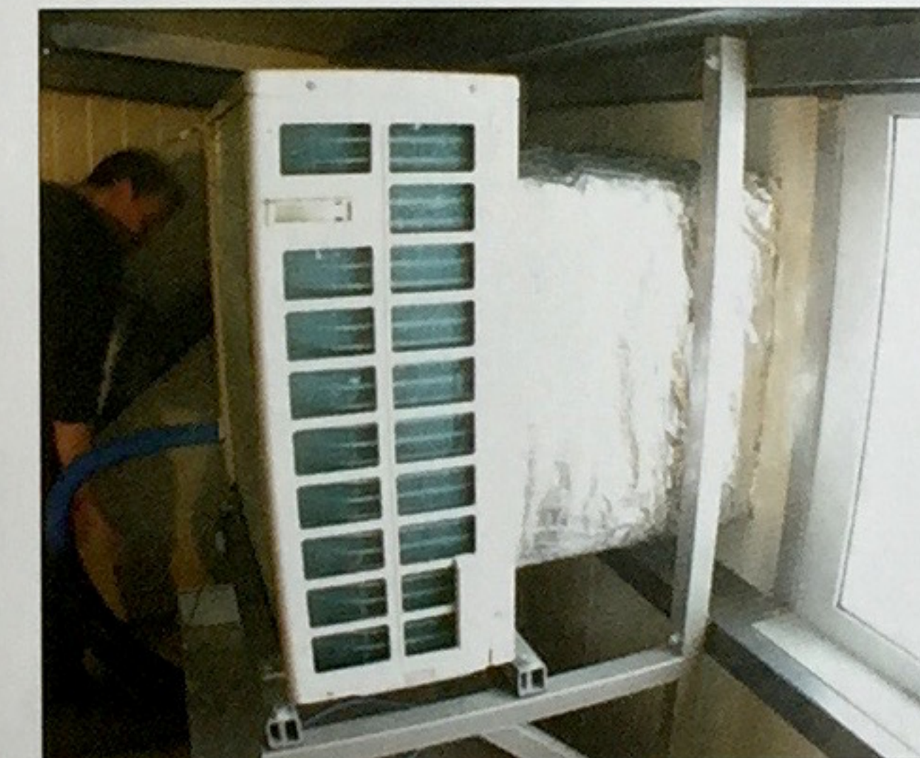
Dans chaque construction, les installations techniques sont placées de manière à exploiter au maximum l'efficacité thermique. Ici par exemple, la PAC Hoval Belaria S de type air-eau est placée dans les combles.
